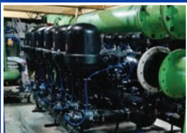
Tratamiento terciario de Aguas Servidas con filtro ARKAL
